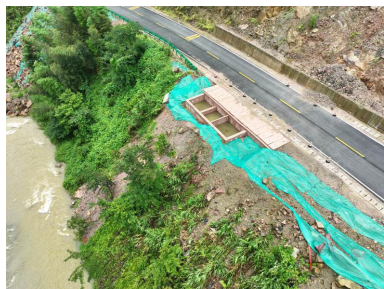
图2 某工程路面径流未接入已建好的并联沉淀池-事故应急池
