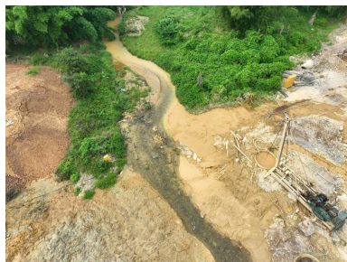
图3 某项目桩基施工泥浆未经妥善处理就汇入河流
