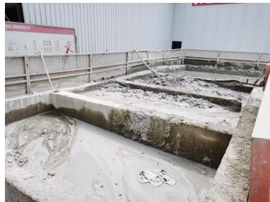
图4 某项目拌和站内沉淀池堆满沉渣导致无法发挥作用
